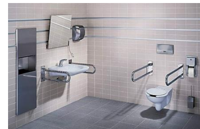
Оборудование санитарной комнаты
